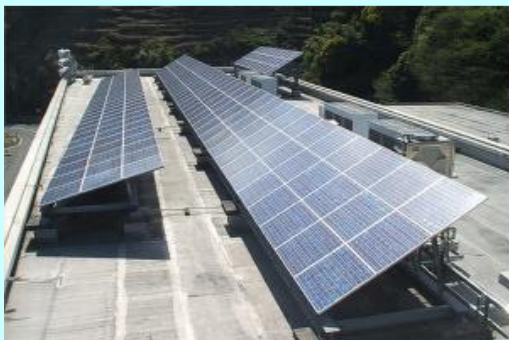
屋上のソーラーパネル(30Kwh)
